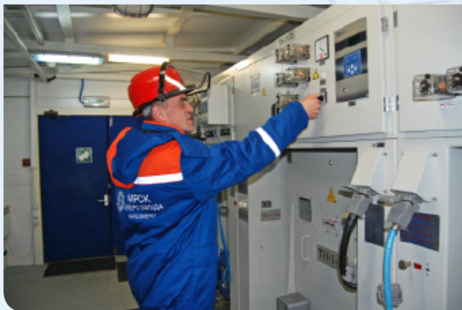
Олег Калятин, старший мастер участка технического обслуживания ПС 35–110 кВ ПО «ЗКЭС»
