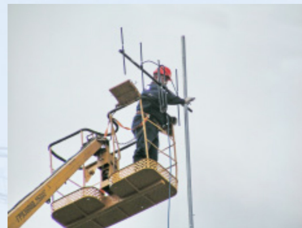
Установка оборудования для телеметрического управления подстанцией
