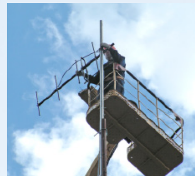
Установка на опору антенны телеметрического комплекса
