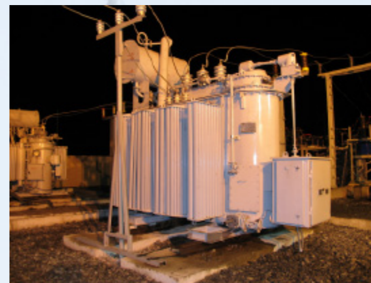
Трансформатор на подстанции в Толвуе
