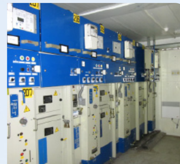
Устройства релейной защиты
