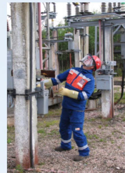
Оперативное переключение на подстанции
